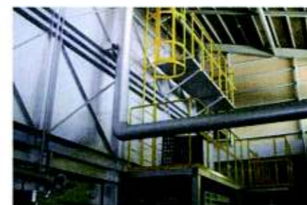
木質バイオマスボイラー(蒸気発生能力5t/h)
